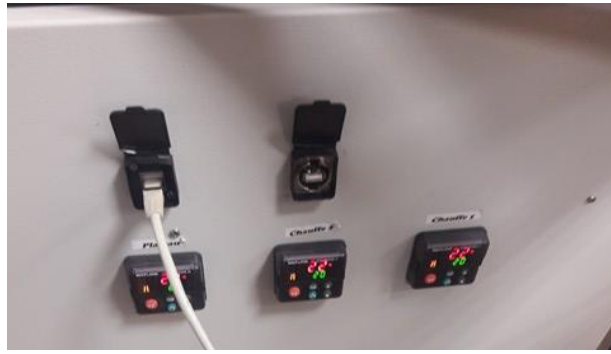
Figure 9 - Régulateurs de température contrôlé via liaison Ethernet
